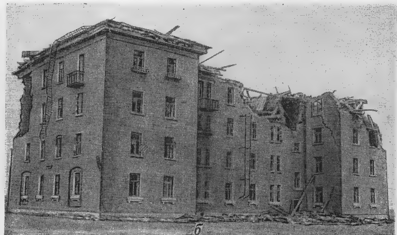
Рис. 107. Четырехэтажный кирпичный жилой дом, находившийся в зоне сильных разрушений: а — до взрыва; б — после взрыва
